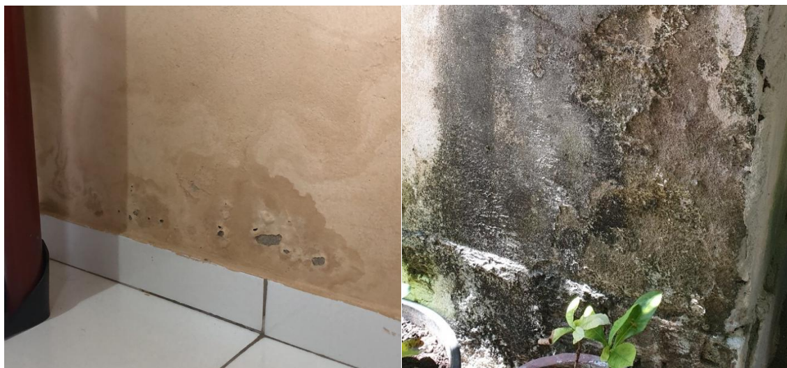
Figura 2 – Patologias causadas pela presença da umidade em paredes
