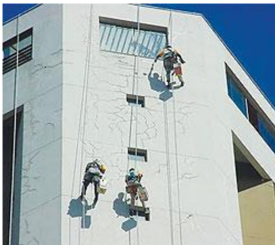
Figura 2 - Fissura mapeada causada por retração de secagem da argamassa.
