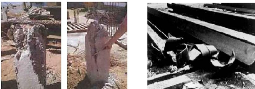
Figura 2 - Danos em Fundações Profundas: a – Danos em estacas pré-moldadas; b – Danos em estacas metálicas
