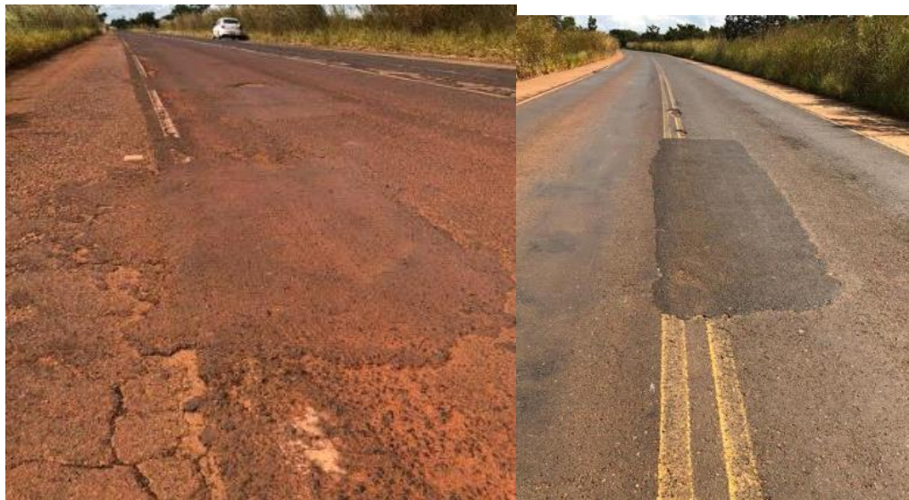
Figuras 11 – Remendos ao longo do trecho.
