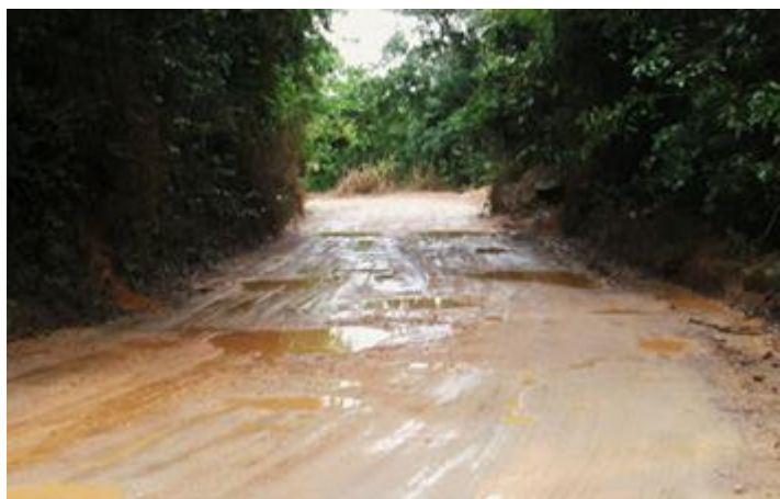
Figura 4 - Defeito: seção transversal inadequada
