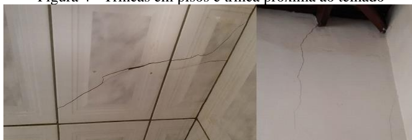
Figura 4 - Trincas em pisos e trinca próxima ao telhado
