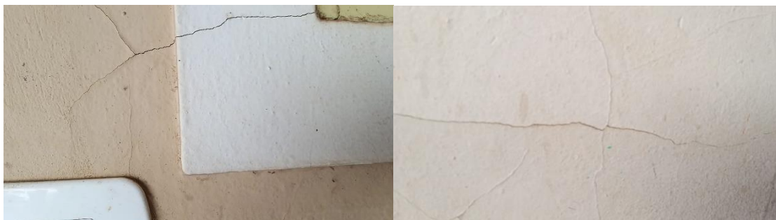
Figura 3 - Fissura na janela e parede
