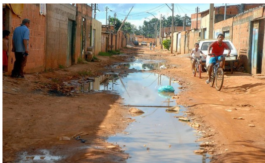
Figura 1 – Esgoto a céu aberto em uma rua de da cidade de Brasília-DF
