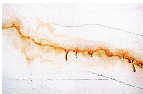
Figura 6 - Exemplos de infiltrações em construções civis Fonte: SOUSA (2014)
